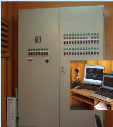
Ηλεκτρικός πίνακας & Τηλεπαρακολούθηση
