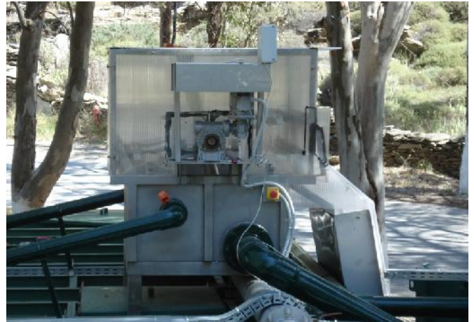
Μονάδα Προεπεξεργασίας (Εσχάρωση)
