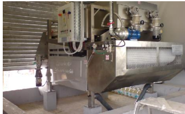
Αφυδάτωση Ιλύος - Φιλτρόπρεσα
